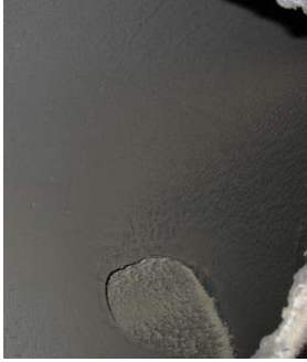
Rohrleitung vor der Reinigung
