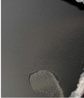
Rohrleitung vor der Reinigung
