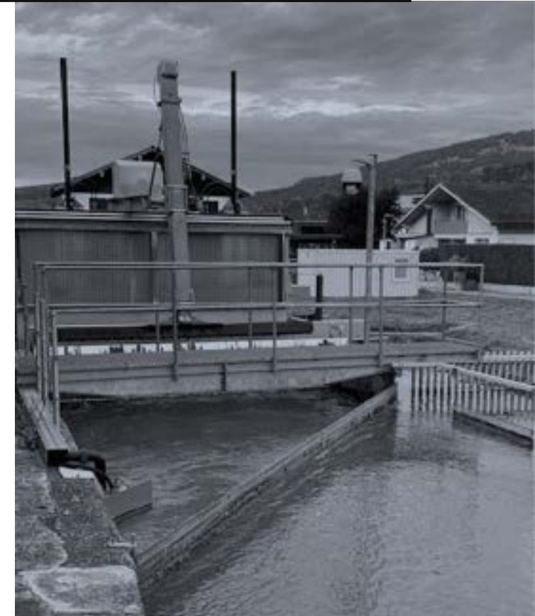
Kleinwasserkraftwerk Martina Walch
